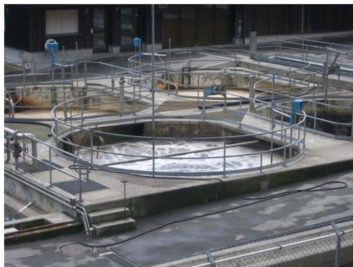
Abbildung 1: Belebungsbecken, Kläranlage Teufen AR
